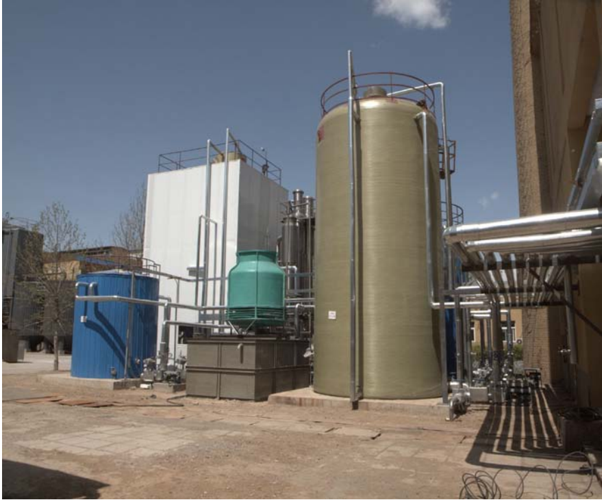
氨水储罐化肥 结晶造粒系统
